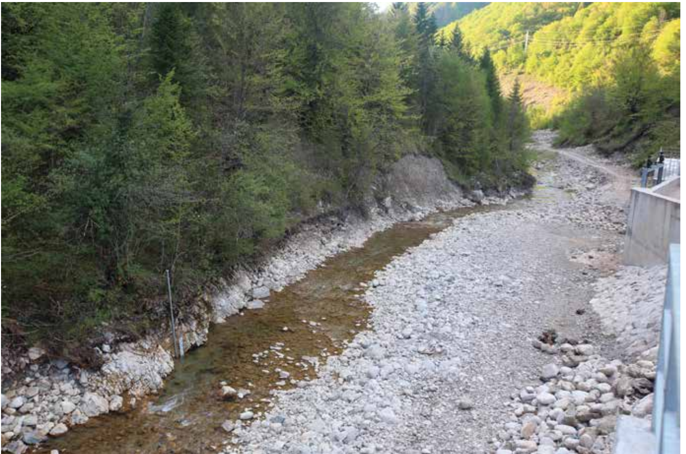
Skoro suho korito rijeke nizvodno od brane MHE Novakovići. Građevinski radovi nisu vršeni u skladu sa ekološkom dozvolom.
